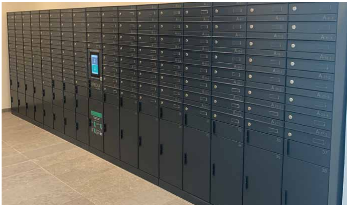
Instalación Univers paquetería + correo
